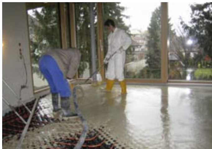
Fußbodenheizungen sorgen für angenehme Temperaturen
