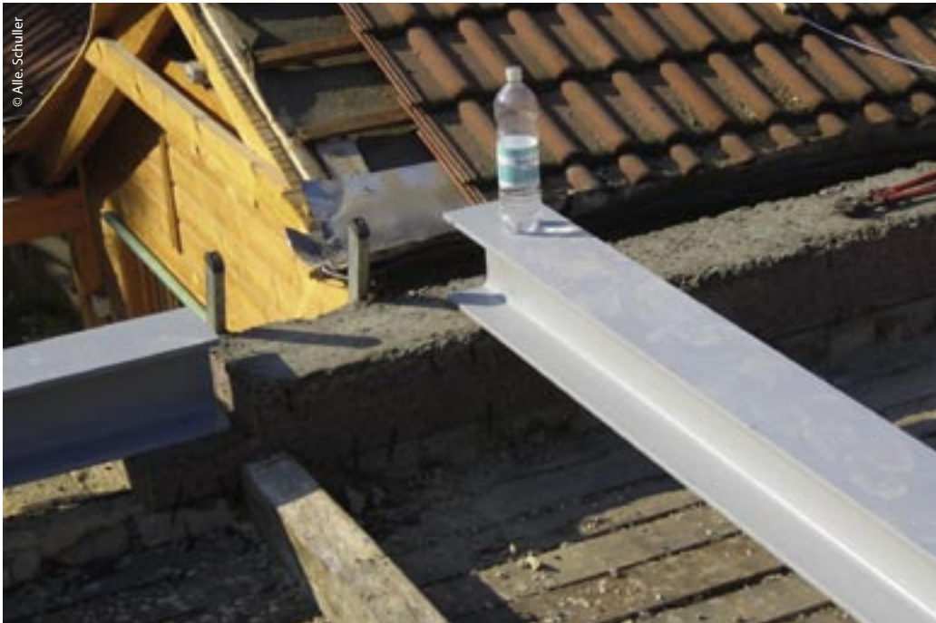
Baudetail: über den Resten der alten Holzdecke wurde ein neuer Trägerrost betoniert bzw. in Stahl errichtet
